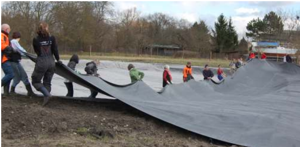
Gemeinsam wird die Folie für den Teich auf der Naturerlebnisfläche AuenLand verlegt
